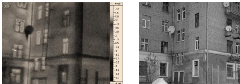
Рис.3.– Дефект конструкції будівлі. Стик між фасадами С і Д.
