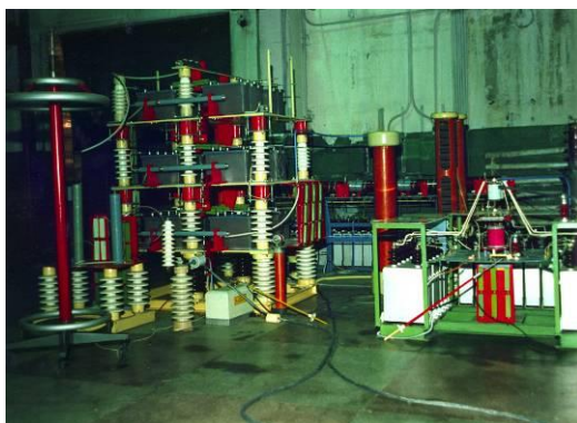
Установка г. Славянск НИИ ВН
