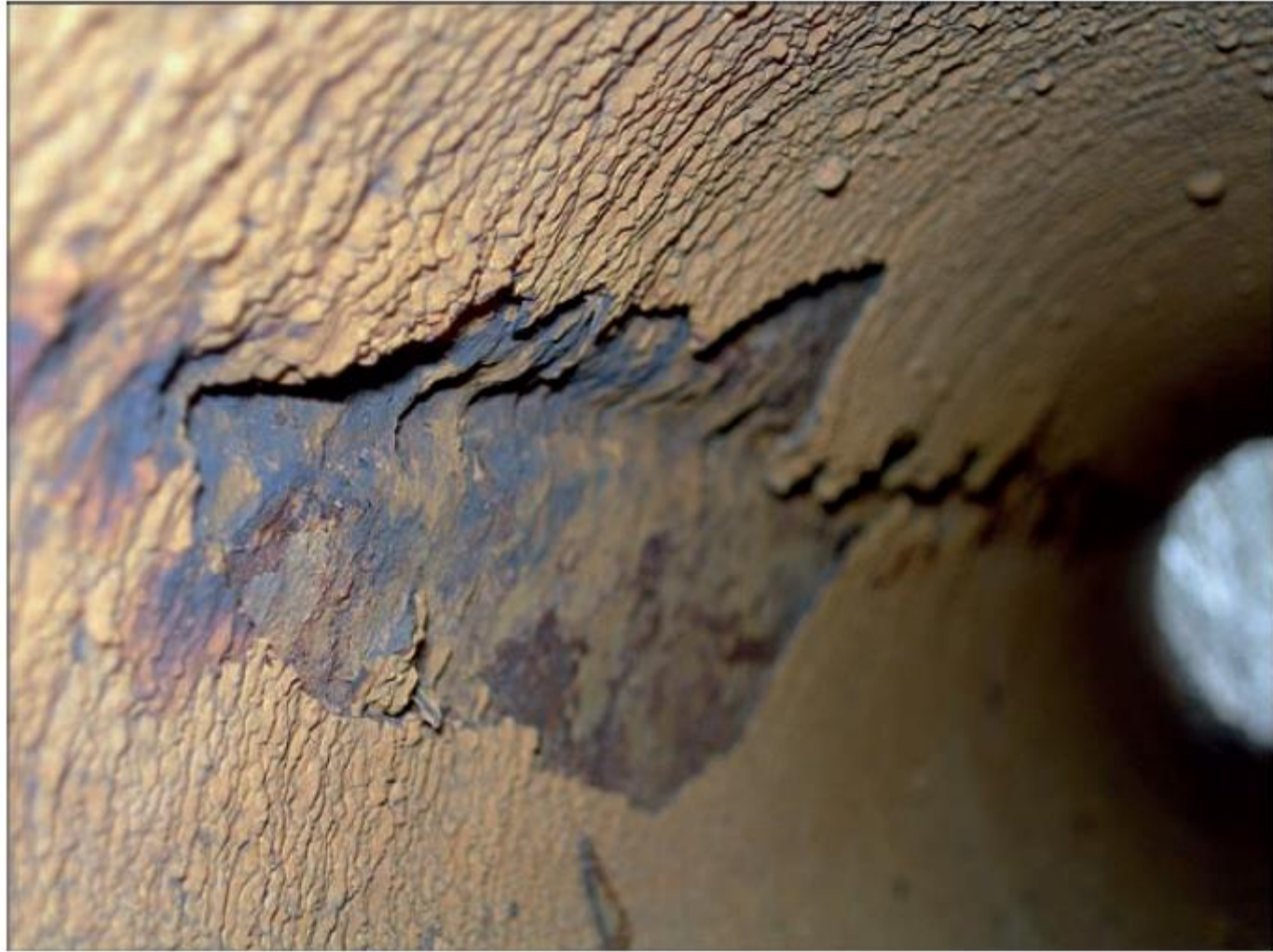
Локальна корозія під відкладеннями
