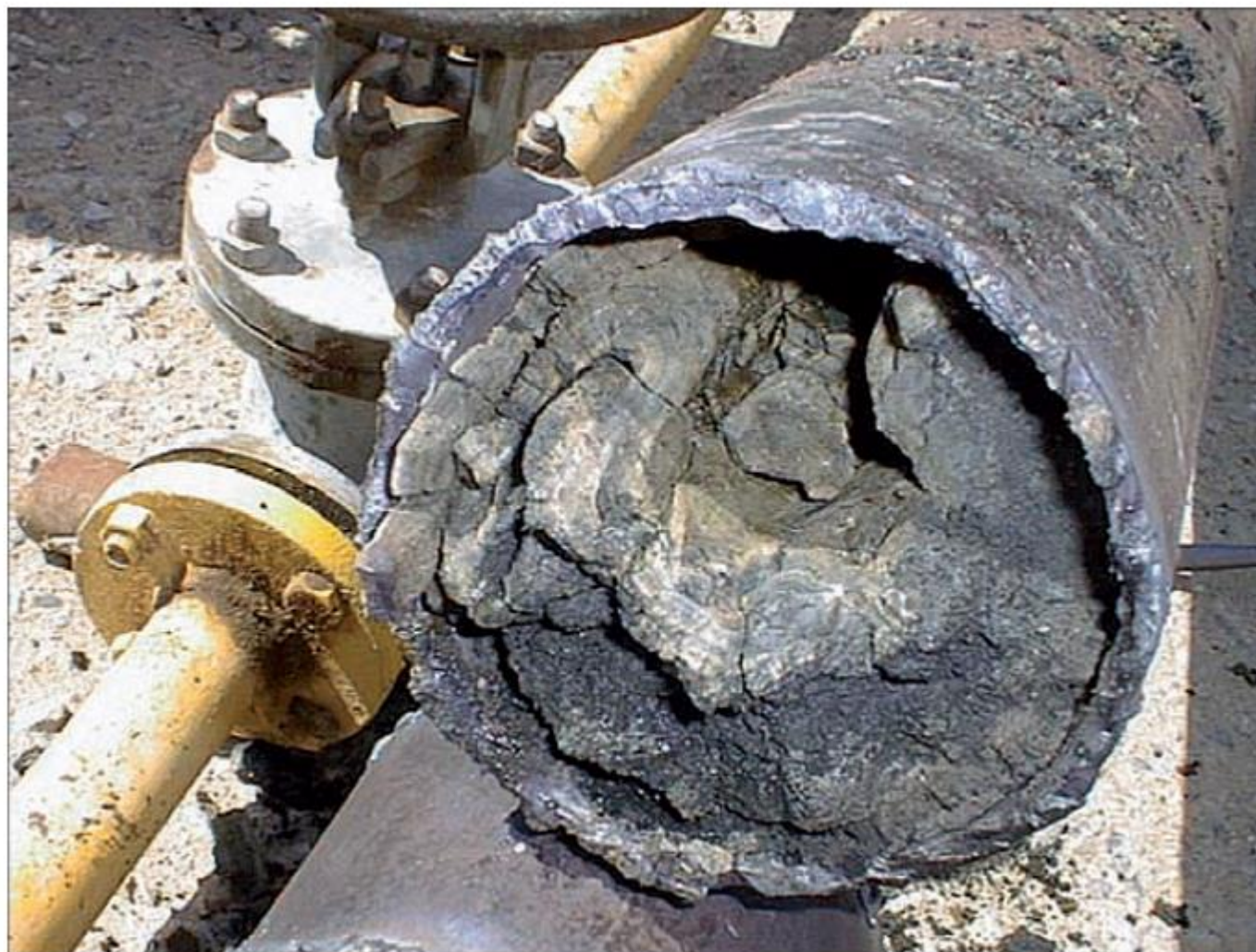
Мінеральні відкладення у нафтопроводі
