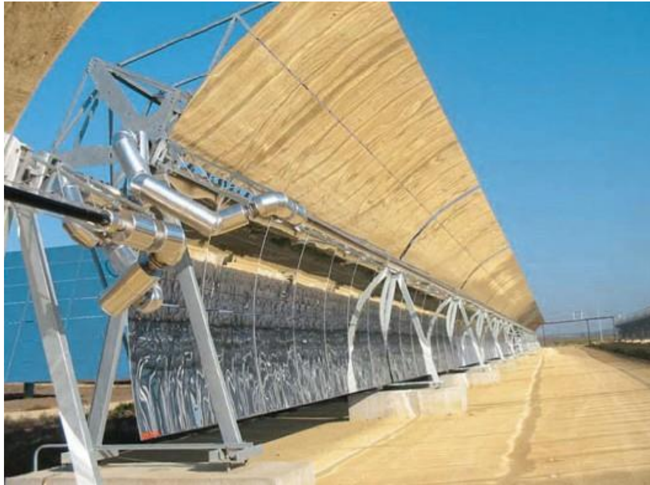
ДОВГІ ПАРАБОЛІЧНІ (В ПОПЕРЕЧНОМУ ПЕРЕРІЗІ) ДЗЕРКАЛА З ТРУБАМИ ДЛЯ РОЗІГРІВАННЯ ТЕПЛОНОСІЯ (ФОТО «SOLUCAR»)
