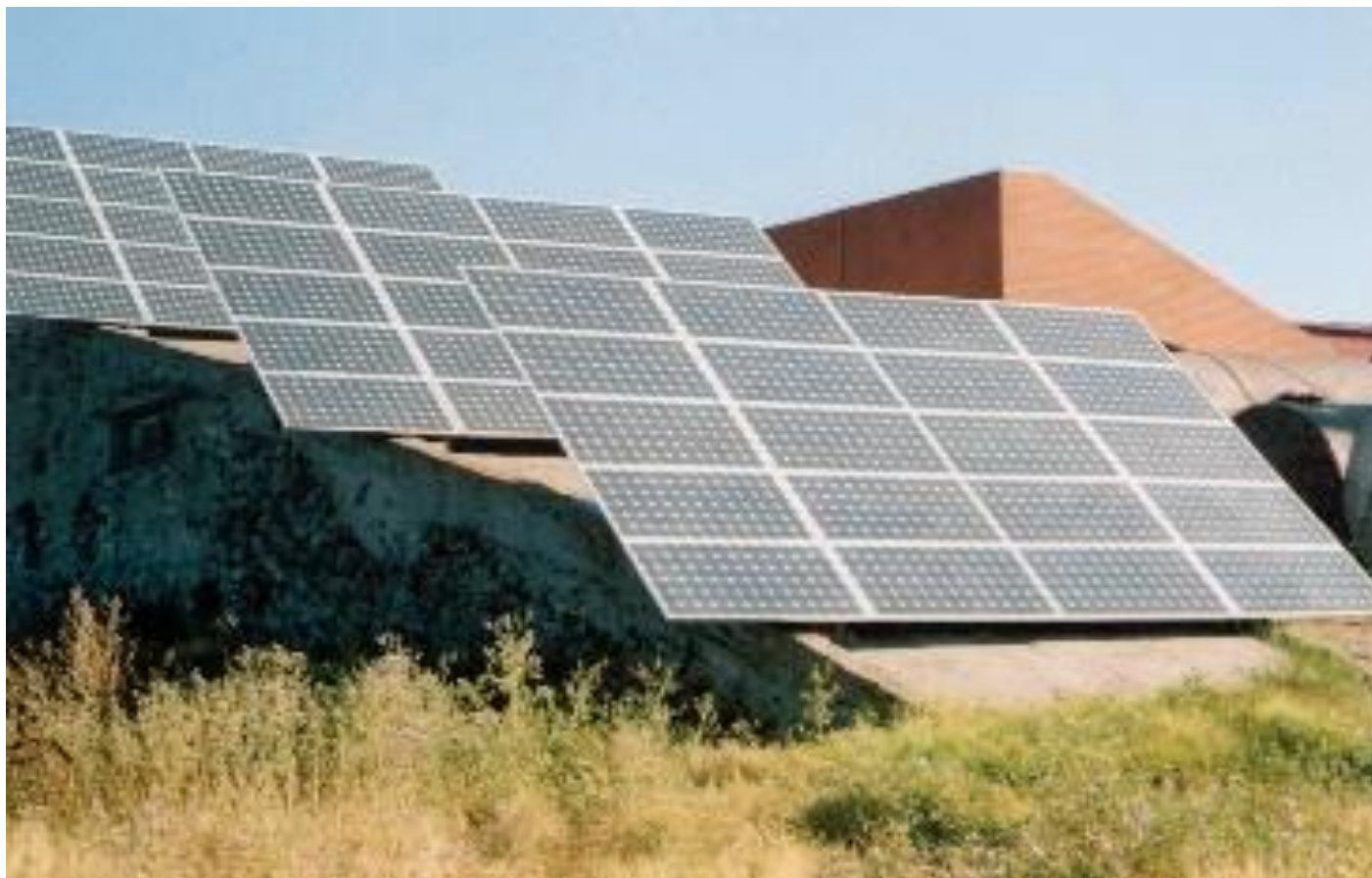
МАЛ. 7. ФОТОЕЛЕКТРИЧНА СИСТЕМА ЕНЕРГОПОСТАЧАННЯ КОМПЛЕКСУ НА О. ЗМІЇНИЙ ПОТУЖНІСТЮ 10 КВТ
