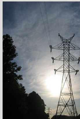
Трифазна двоколока лінія електропередач
