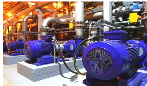
Асинхронний двигун для насосної підстанції
